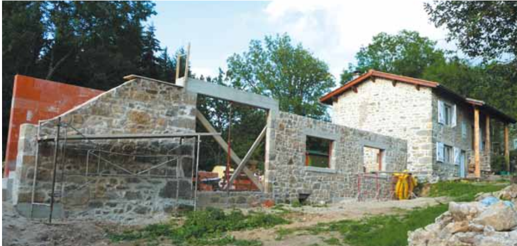
Les murs nord et sud ont pu être conservés. On aperçoit à droite l'autre maison, précédemment rénovée.
