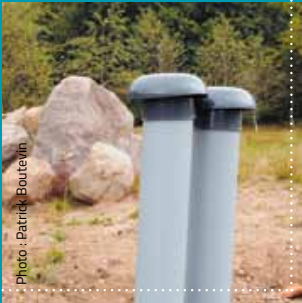
Photo : Patrick Boutevin Bien dimensionné, le puits canadien permet de préchauffer l'air neuf entrant.
